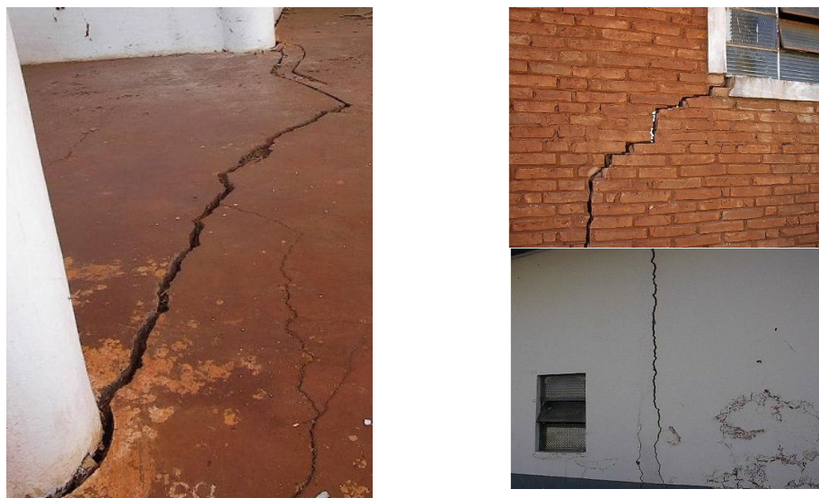
Fig. 2.10: Danos causados pelo colapso do solo às margens do lado Três Irmãos (Rodrigues, 2007)
